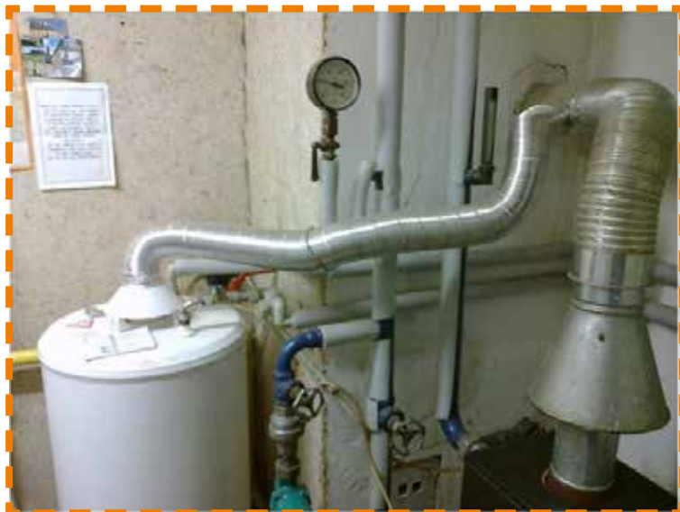
Příklad složitého provedení spalinové cesty a špatně provedeného průchodu spalinové cesty hořlavou konstrukcí.
